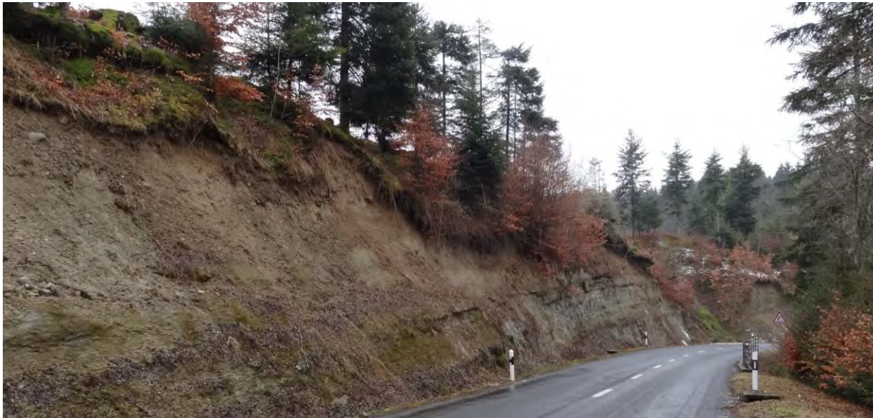
Figure 3 : Phénomène de desquamation de la molasse et de glissements superficiels au niveau du talus escarpé, le long de la route cantonale en direction de Monpreveyres.
