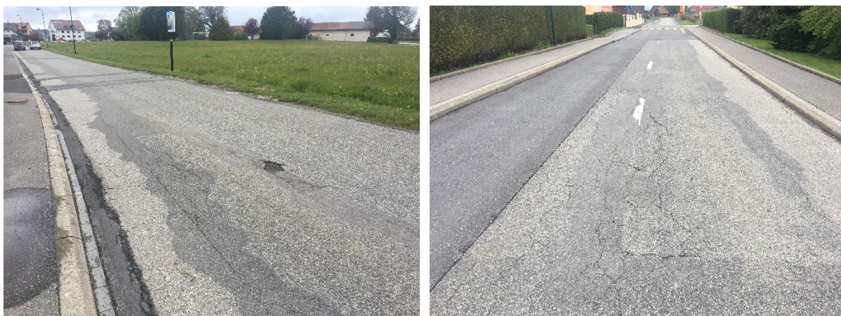
Photos 1 & 2 : RC 637 – Dégradations de types nids de poule et faïençage
