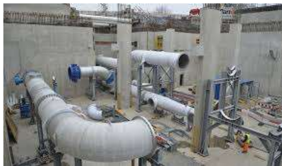
Pompage au lac et réseau energie
